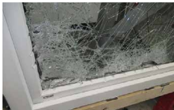
Schäden aus der manuellen Prüfung
